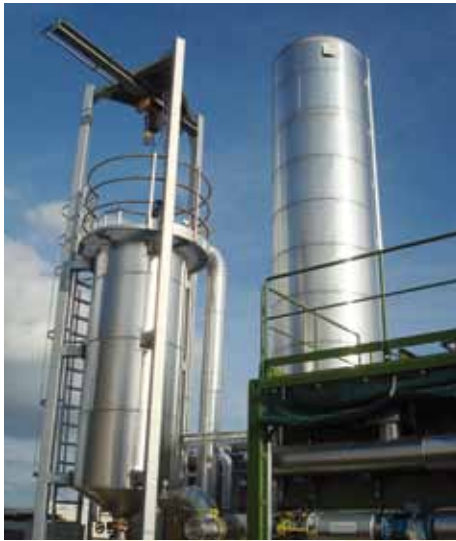
Eine Anlage des Biogas Pool 2
